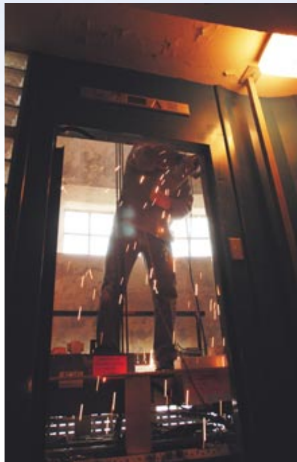
En 2007, l'Office a doublé le budget consacré aux travaux d'ascenseurs.
