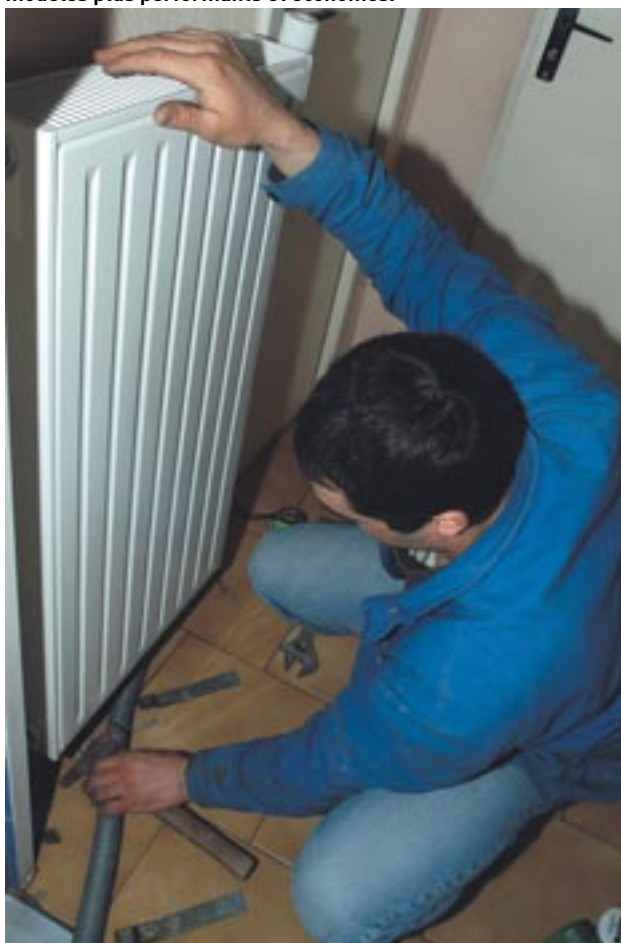
Remplacement des radiateurs individuels par de nouveaux modèles plus performants et économes.
